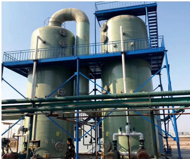
净化喷淋塔 spray tower
