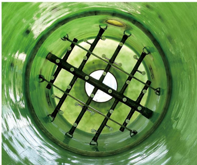
塔内件 column internals
