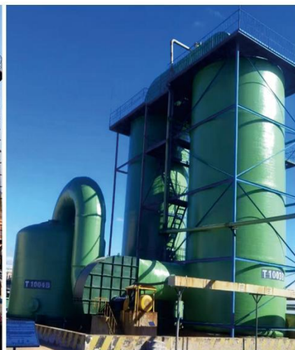
吸收塔 Absorption tower
